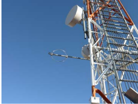
(b) Montierte Beacon-Sendeantenne (SALLA) am Kommunikationsturm von Coihueco.
